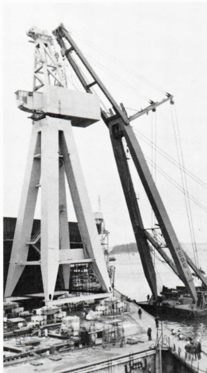
Nakskov Skibsværfts nye 100-tonns beddingkran blev i weekend'en 27. og 28. marts bragt på plads af 400 tons-flydekransen "Hebe".
