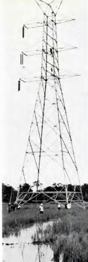
Højspændingsmast i Thailand. Fra den kæmpemæssige Yarnhee-dæmning i Nordthailand føres elektricitet direkte til Bangkok og områderne der omkring.
